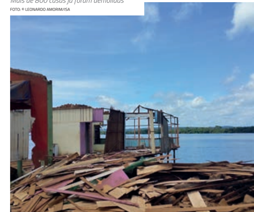
Restos de construção na orla de Altamira. Mais de 800 casas já foram demolidas FOTO: © LEONARDO AMORIM/ISA
