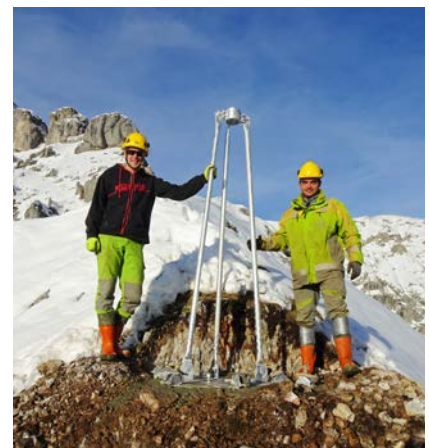
Installation einer Wetterstation für die Eiskarlawine, Gde. Ramsau am Dachstein
