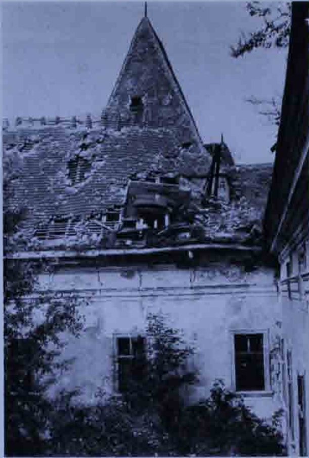
Abb. 5. 1966: West-Trakt, NW-Ecke innenhofseitiges Dach mit zusammengebrochener Dachgaube.
