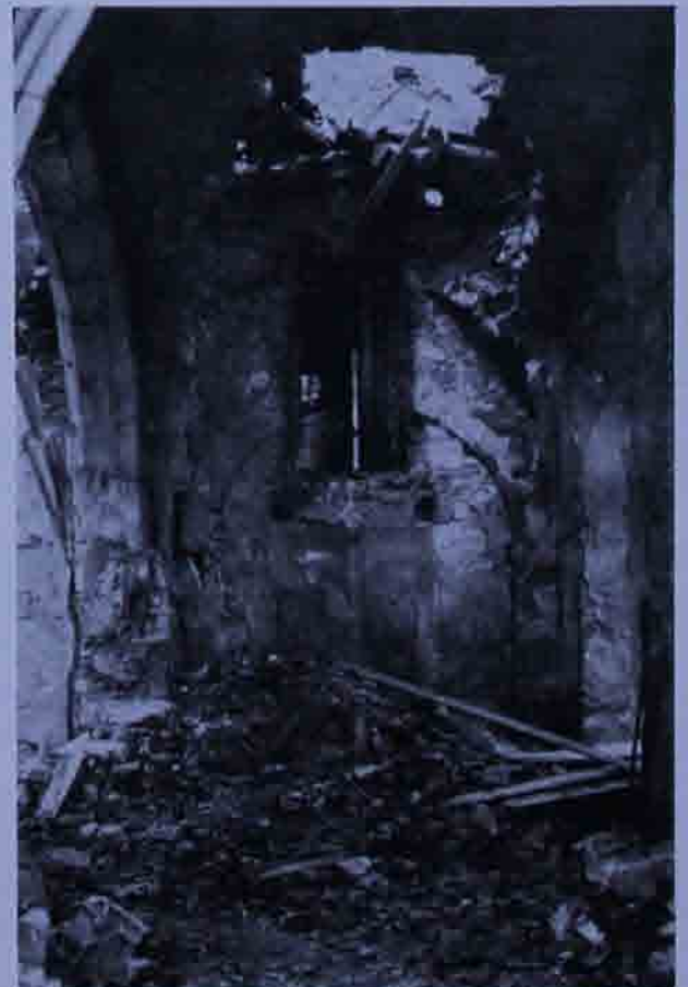
Abb. 8. Oktober 1967: Kapelle, Südseitenschiff. Oben das auf vandalische Weise zum Einsturz gebrachte Gewölbe.
