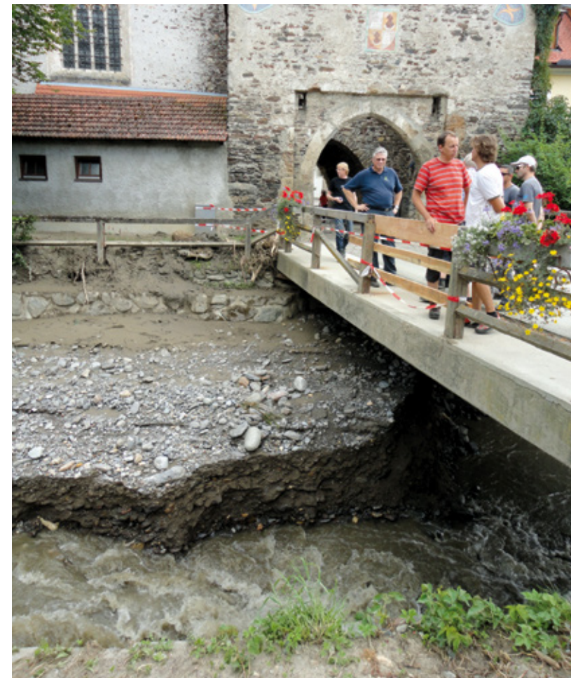
Abb. 5: 07 July 2011 - Geschiebeanlandungen im Unterlaufgerinne beim historischen West-Tor der Stadtmauer von Oberwölz
