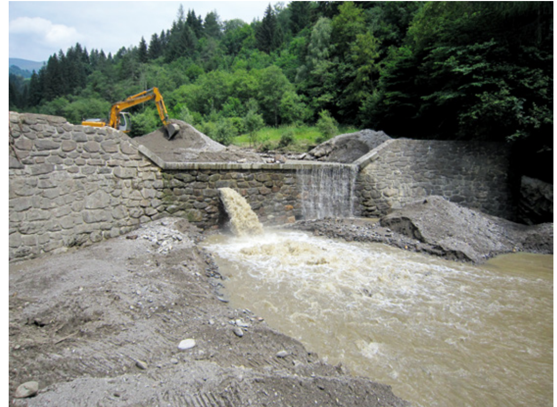
Abb. 3: Völlige Verfüllung der bestehenden Dolensperre in hm 24,5 beim Ereignis am 07. Juli 2011 – geplanter Umbau zu einem Wildholzrechen
