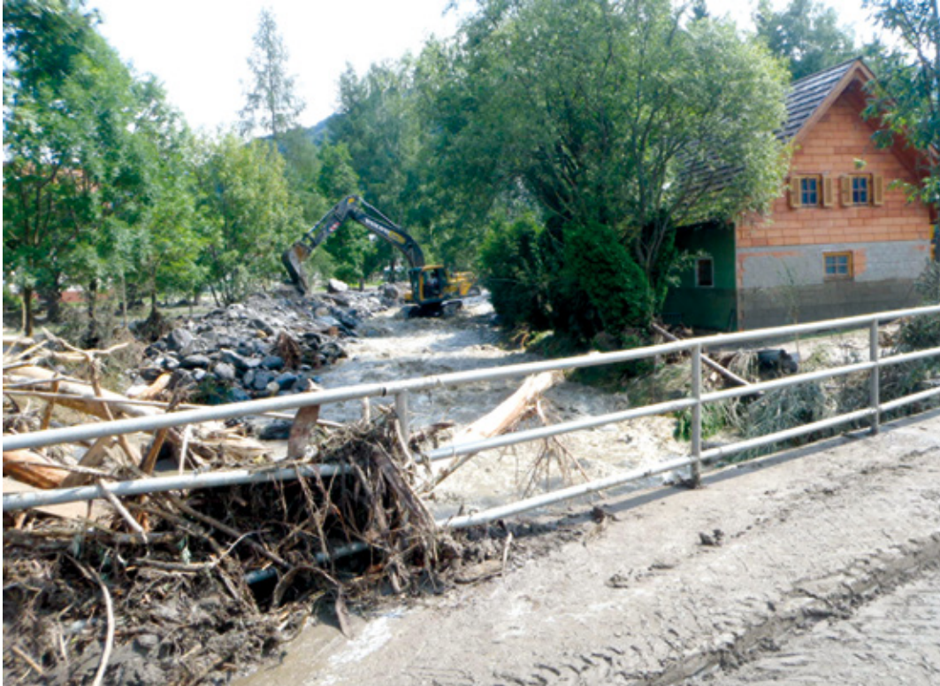
Abb. 4: 07. Juli 2011- Teilverkläuserung der Landstraßenbrücke und damit verbundene Geschiebeanlandung im Unterlaufgerinne
