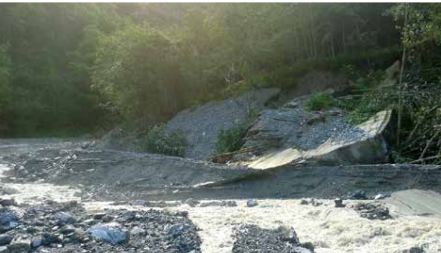
Abb. 1: zerstörte Sperre bei hm 18,62 (linksufriger Sperrenflügel)
