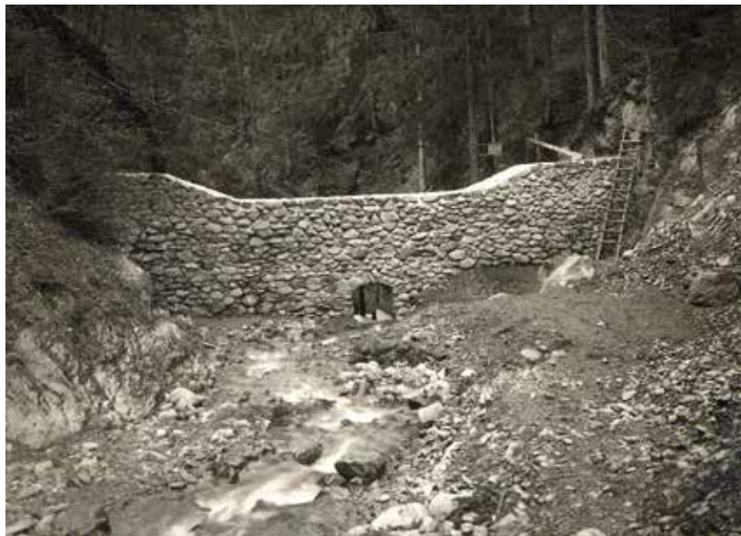
Abb. 2: Querwerk an der Spitze des Schwemmkegels des Lahnaches, Projekt 1911 der WLV
