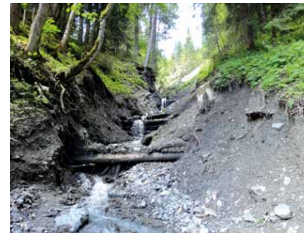
Abb. 2: Desolate Holzkästen nach einem Murgang
