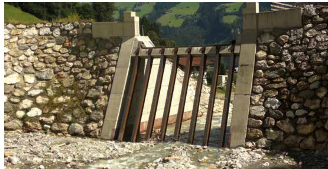
Abb. 10: Trogsperre Sidanbach mit Rechen, Gde Schwendau im Zillertal (BJ 2016/2017)
