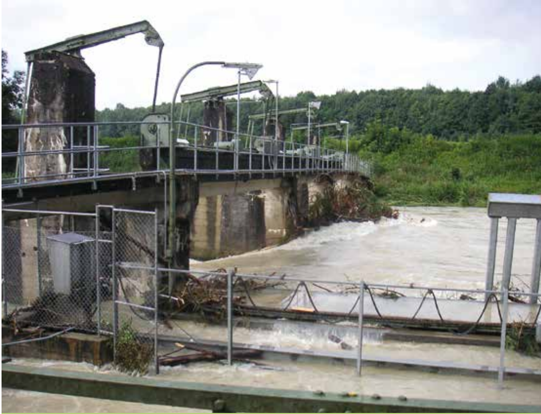
Abb. 2: Verklaustes Wehr bei Bruckmühl - Hochwasser 2004 (Foto: WWA Rosenheim).
