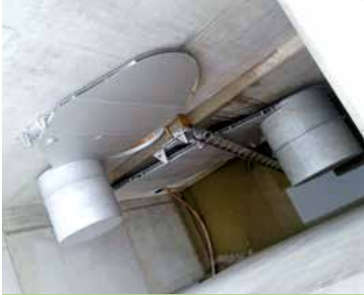
Abb. 6: Abflussregler Hydroslide Fa. Steinhardt
