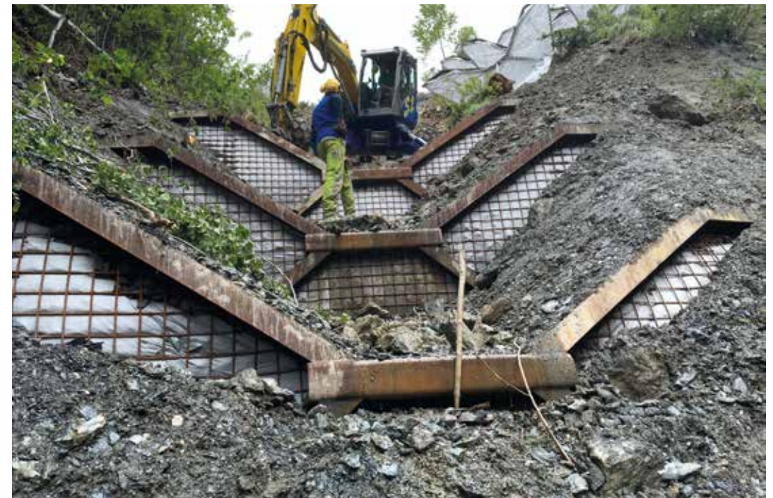
Abb. 9: Gerinnesicherung mit "Farfalle Stahlelementen" im Bereich Feigental, Gemeinde Sillian
