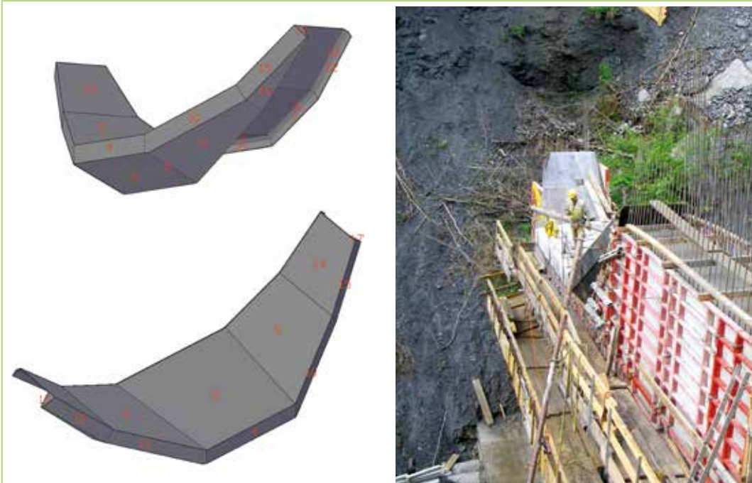
Abb. 1: 3D-Planung einer Stahlabflusssektion (linkes Bild) zur Ermittlung der Zuschnitte und Kantungen und Einbausituation in Verbindung mit der Großflächenschalung (rechtes Bild) (Beispiel Putzengraben/Gemeinde Schwarzach, Foto WLV)
