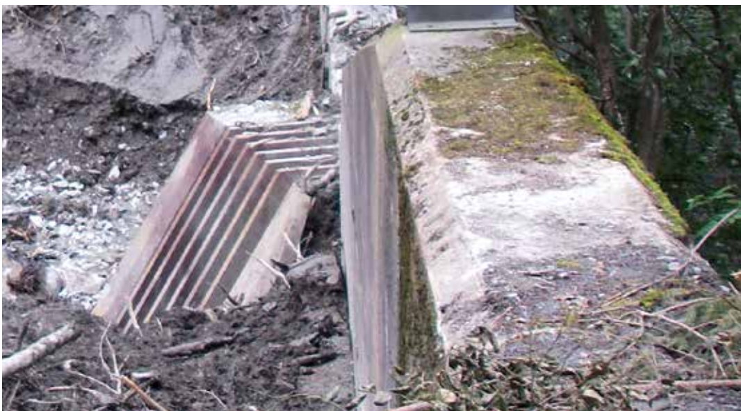
Abb. 8: Ablösung der Stahlblechverkleidung bei einer überstehenden Kante. Die Beschädigung wurde durch einen Bagger im Zuge der Räumung verursacht. Sortierwerk – Marislbach/Gem. Zederhaus – JAP 1992
