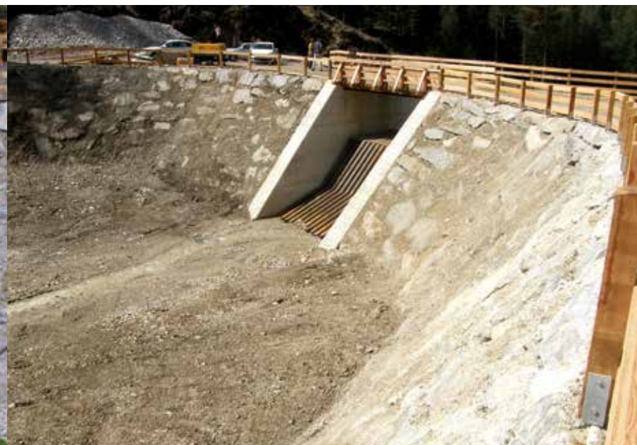
Abb. 11: Trogsperre mit geknicktem schrägen Rechen, Pulvermühlbach, Gemeinde Achenkirch (BJ 2010/2011)
