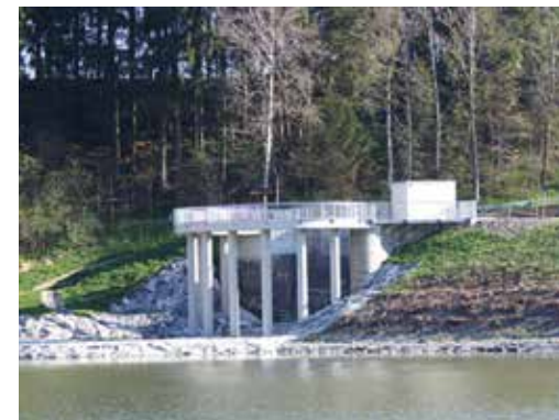
Abb. 8: Einlaufbauwerk der Hochwasserentlastungsanlage am Grüntensee mit Schutzeinrichtung zum Schwemmhölzrückhalt (unten) und Bauwerk im Modell (oben)
