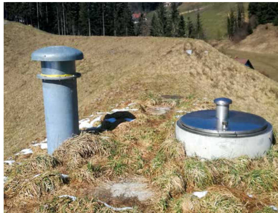
Abb. 11: Piezometer und Inklinometer
