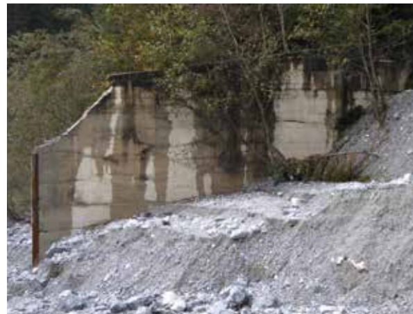
Abb. 8: Erhalten gebliebener rechtsufriger Flügel der Sperre hm 18,62
