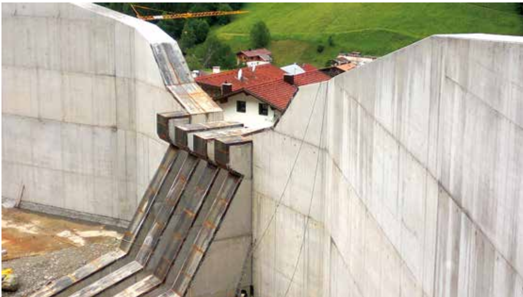
Abb. 12: Geschiebesortiersperre Schallerbach, Gde See Geknickter Rechen in Form von Betonscheiben mit Stahlabdeckung
