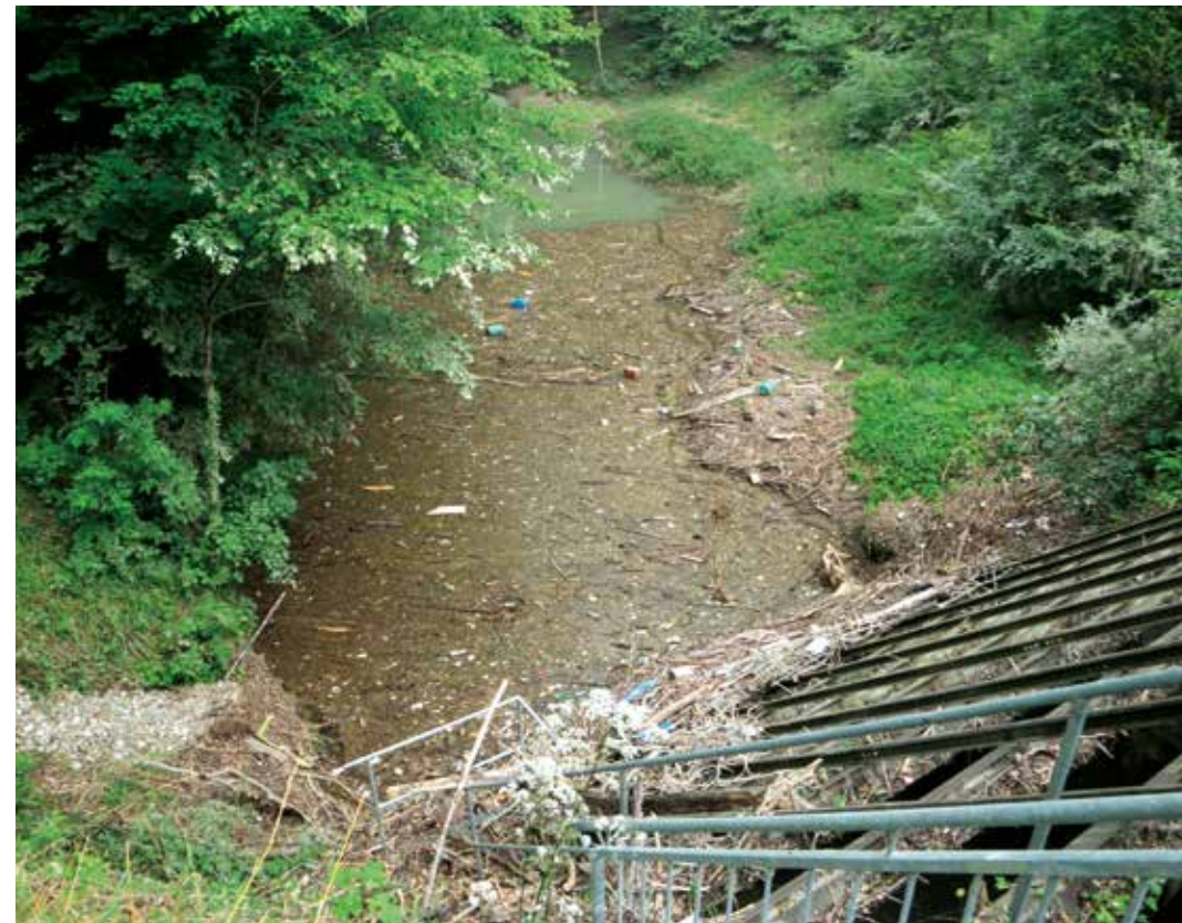
Abb. 5: Sehr steiler Rechenteil führt zu einer unerwünschten Verlegung. Hoher Betreuungsaufwand infolge unnötiger Ablagerung der Feststoffe
