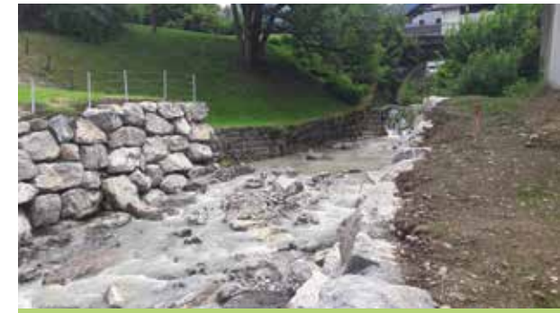
Abb. 1: Abstürze durch Kolkbildungen bis zu 2 m waren in der Verbauungsstrecke von 4,7 km zu finden.
