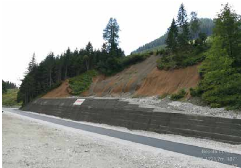
Abb. 3: Schadstelle bei ca. km 20,0 am Ende der zweiten Bauphase; 24.07.2018 (Foto: C. Schmidt).
