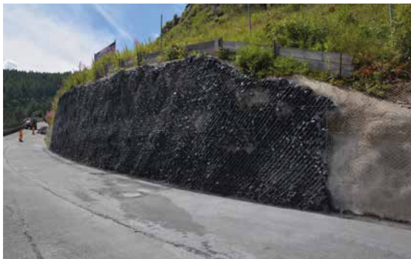
Abb. 1: Spritzbetonwand inklusive Begrünungssystem ohne Vegetation am 27.07.2016 (oben) und Spritzbetonwand inklusive Begrünungssystem mit Vegetation am 21.08.2017 (unten).
