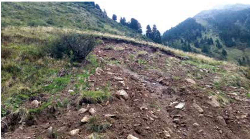
Abb. 6: Schadstelle bei ca. km 32,4 etwa einen Monat nach den Unwetterereignissen; 06.09.2017 (Foto: C. Schmidt).
