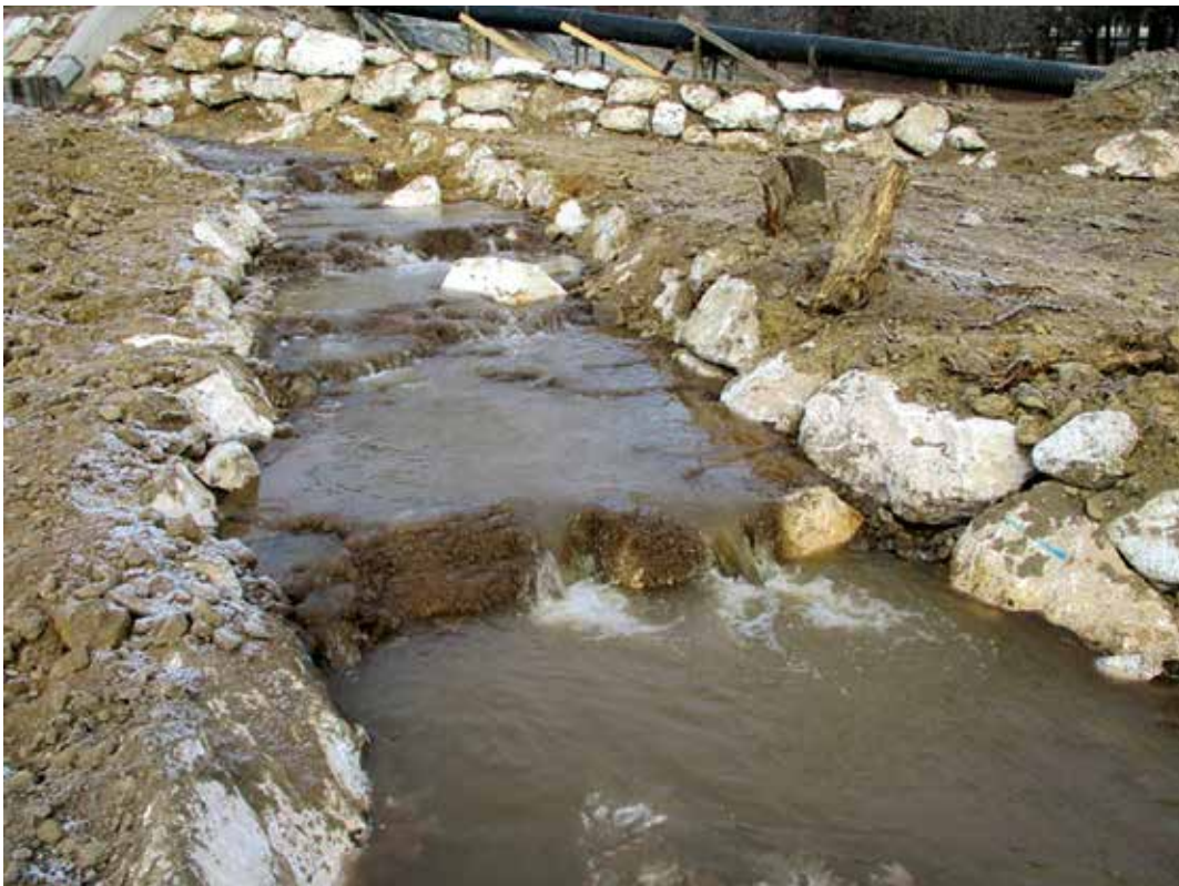
Abb. 3: Sohlsteine zur Strukturierung des Bachlaufes und linksufrige Prallwand kurz nach Fertigstellung, Tronitzerbach
