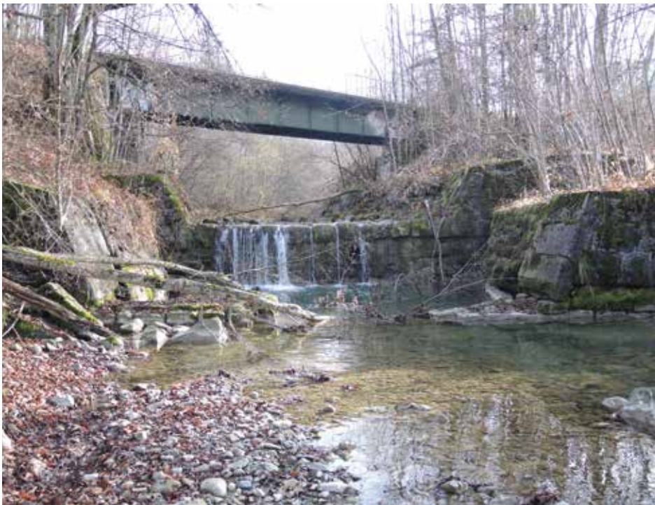
Abb. 8: Sohlkonsolidierung zur Sicherung der ehemaligen Bahnbrücke, die Vorsperre ist bereits zerstört.
