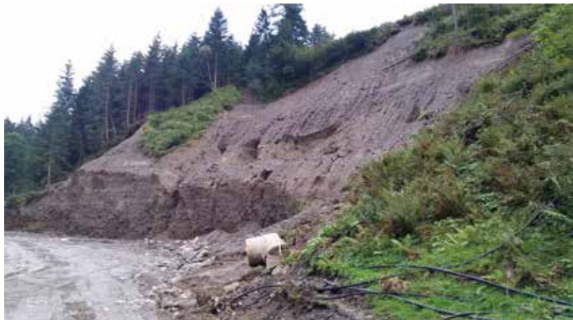
Abb. 2: Schadstelle bei ca. km 20,0 etwa einen Monat nach den Unwetterereignissen; 06.09.2017 (Foto: C. Schmidt).
