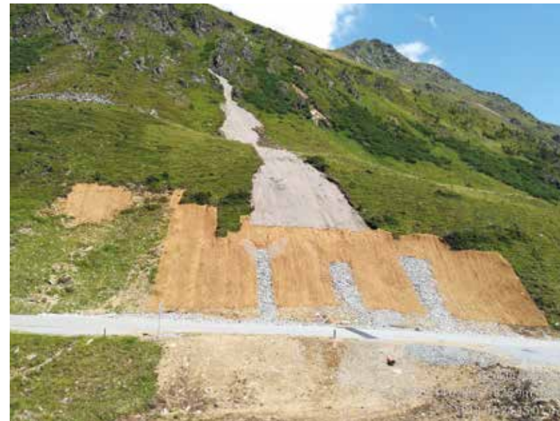
Abb. 5: Schadstelle bei ca. km 30,7 am Ende der zweiten Bauphase; 24.07.2018 (Foto: C. Schmidt).
