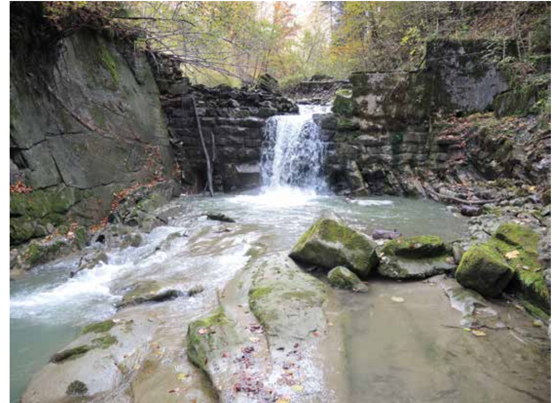
Abb. 1: Eine Konsolidierungssperre im Schmiedlebach aus den 40er Jahren des letzten Jahrhunderts.
