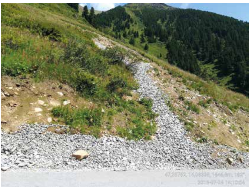
Abb. 7: Schadstelle bei ca. km 32,4 am Ende der zweiten Bauphase; 24.07.2018; diese Fläche wurde bereits im Zuge der ersten Bauphase im Oktober 2017 fertiggestellt (Foto: C. Schmidt).
