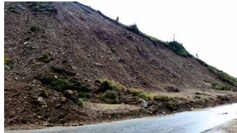
Abb. 4: Schadstelle bei ca. km 30,7 etwa einen Monat nach den Unwetterereignissen; 06.09.2017 (Foto: C. Schmidt).
