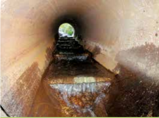
Abb. 2: Blick in ein strukturiertes Rohr mit gleichsohliger Anbindung. Fotos: H. Haseke 15.10.2015
