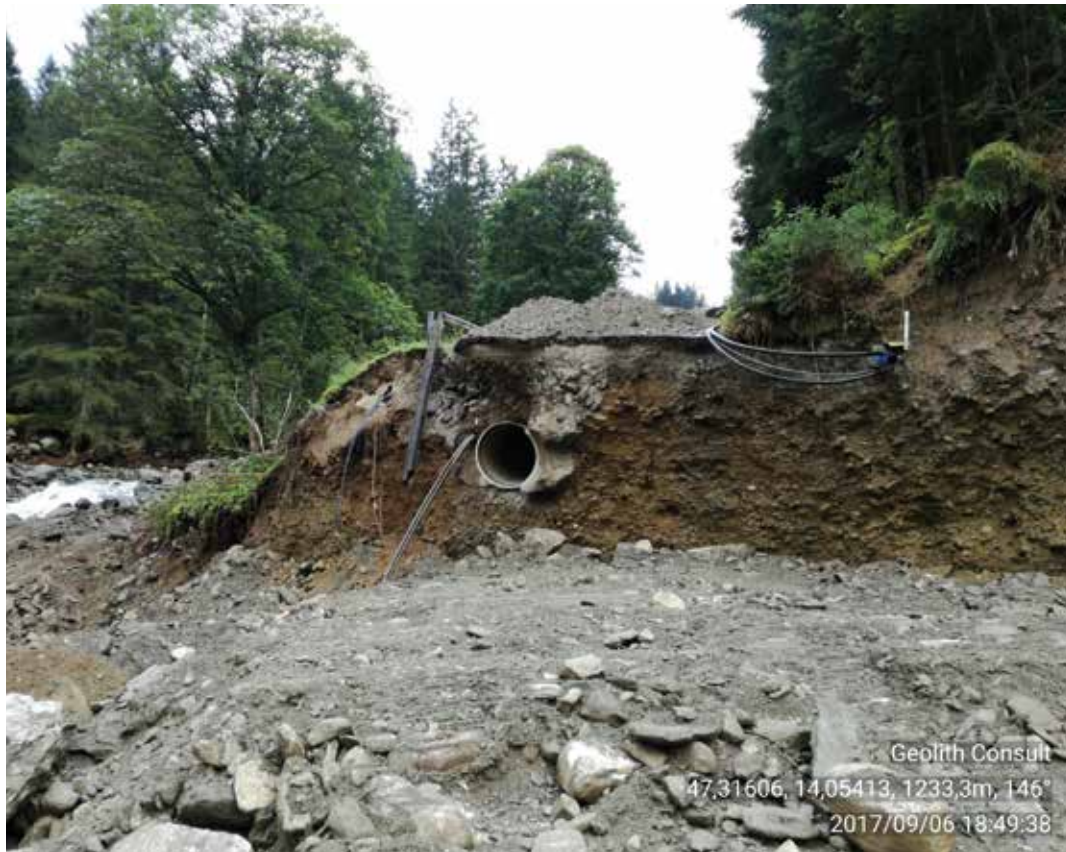
Abb. 1: Weggerissene Straße samt Unterbau und Leitungen bei ca. km 20,0; 06.09.2017 (Foto: B. Imre, Geolith Consult).
