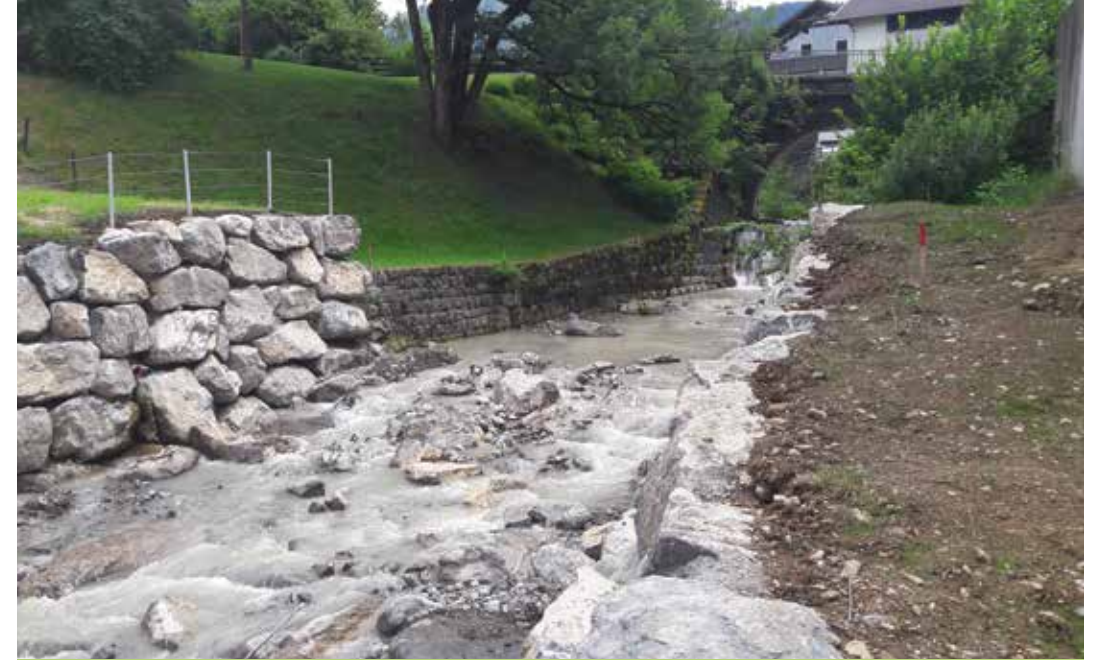
Abb. 13: Fertigstellung des Rampenvorbaus mit einer Neigung bis zu 10 %; der hintere Bereich zum letzten Absturz ist noch nicht fertig gestellt.
