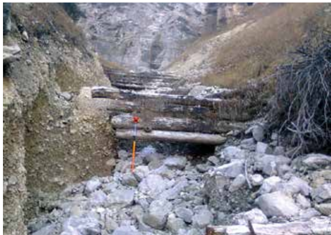
Abb. 2: Sulzgraben – im Zuge des Ereignisses 2010 wurde die Verbauung aus hölzernen Querwerken stark beschädigt bzw. weitreichend zerstört.
